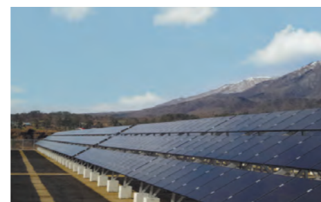
パネルごとに上下で隙間を開けて積雪を滑らせて落とす架台も人気です。
