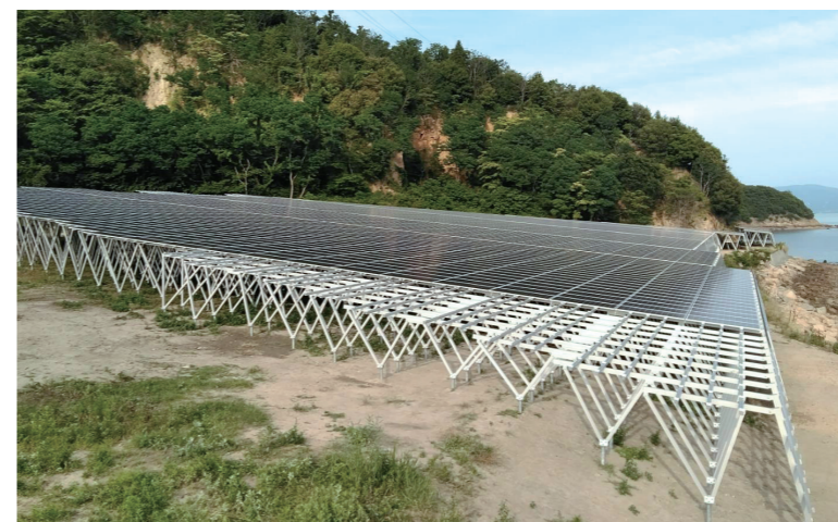
新技術で防風効果と狭小地へ大量設置
